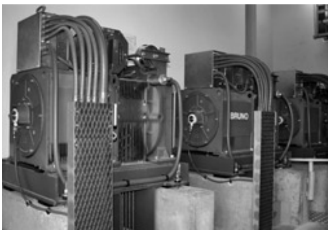
Liftmaschinenraum Nordkopf, Liftmotoren
