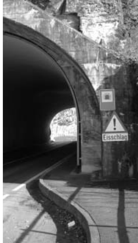
Eisschlag oder Glatteis durch Felswasser – Tunnels in den Bergen haben im Winter ihre Tücken.
