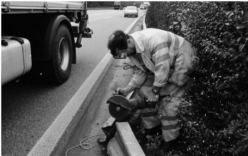
Auch unter NFA sind Angestellte des Kantons auf den Autobahnen im Einsatz: zum Beispiel für kleine Reparaturen.
